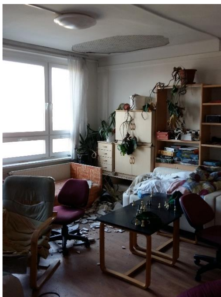
A leszakadt társalgóplafon
