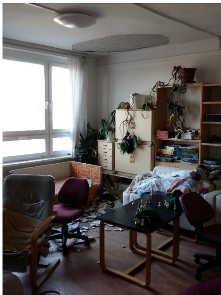
A leszakadt társalgóplafon
